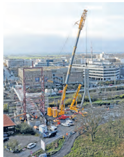
Der 112 Tonnen schwere Pylon in Form eines umgedrehten Ypsilons steht zum Einhub bereit. (Foto Buck)
