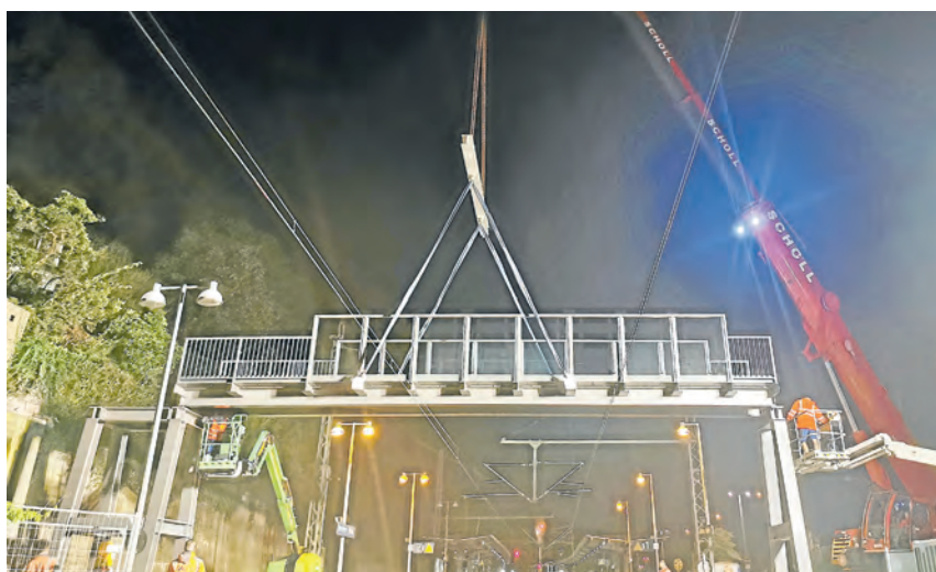
Der 37 Tonnen schwere Verbindungssteg schwebte in nächtlichen Sperrpausen mittels eines Schwerlastkrans über die Gleise des Altstadtbahnhofs. (Foto Stadt Heidelberg)
