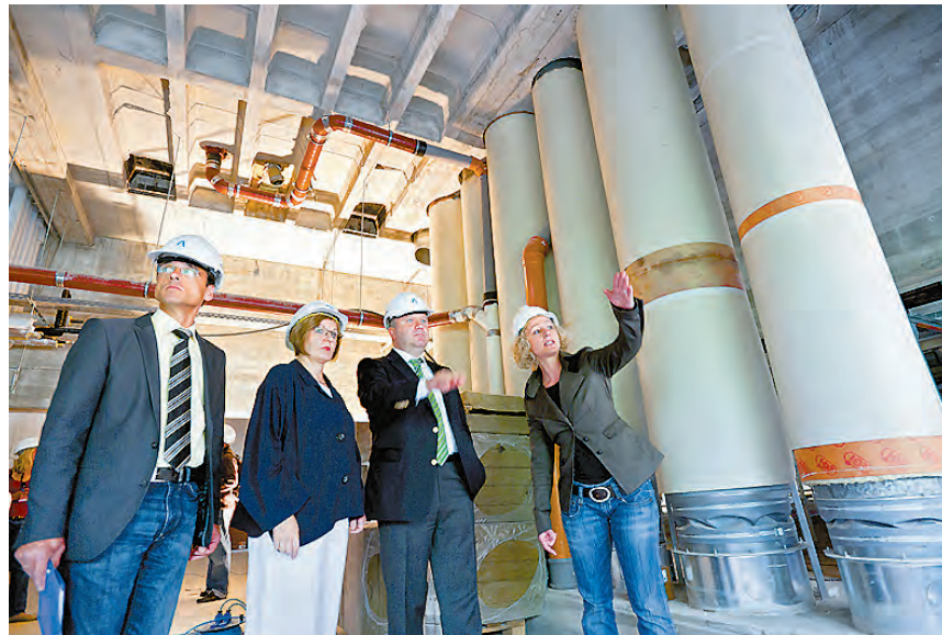
Architektin Maren Reichel (v. r.) erläutert dem Ersten Bürgermeister Bernd Stadel, Xenia Hirschfeld vom Gebäudemanagement und Stephan Brühl vom Amt für Schule und Bildung die Sanierung des Bürgersaals Emmertsgrund. Foto: Rothe
