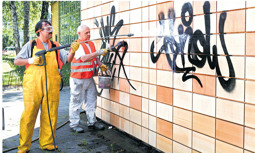
Das Entfernen der Graffiti und das Reinigen der Wände ist außerordentlich aufwändig und kostspielig.
