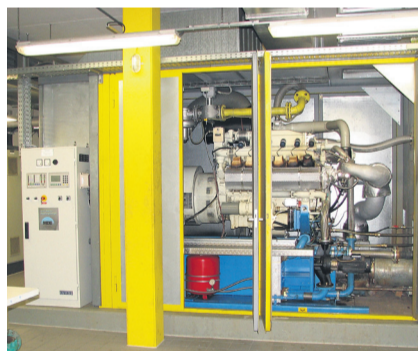
Das Innenleben eines Klärgas-Blockheizkraftwerks. Foto: SWH
