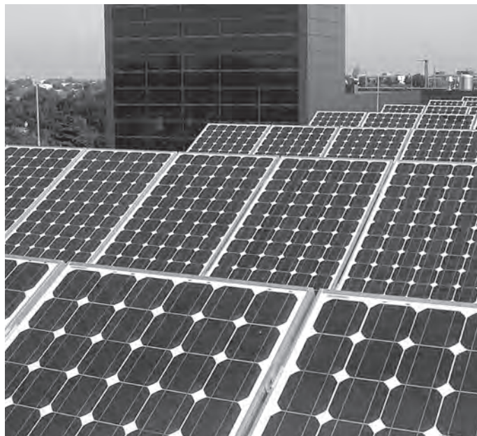
Photovoltaikanlage Berufsfeuerwache Heidelberg
