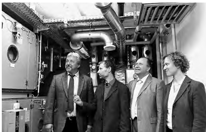
V.l. Heinz Schmitt, Vorsitzender des Stadtteilvereins Pfaffengrund, Architekt Markus Hammel, Erster Bürgermeister Bernd Stadel und Christina Lepold vom städtischen Gebäudemanagement in dem neuen Technikraum. Foto: Dorn
