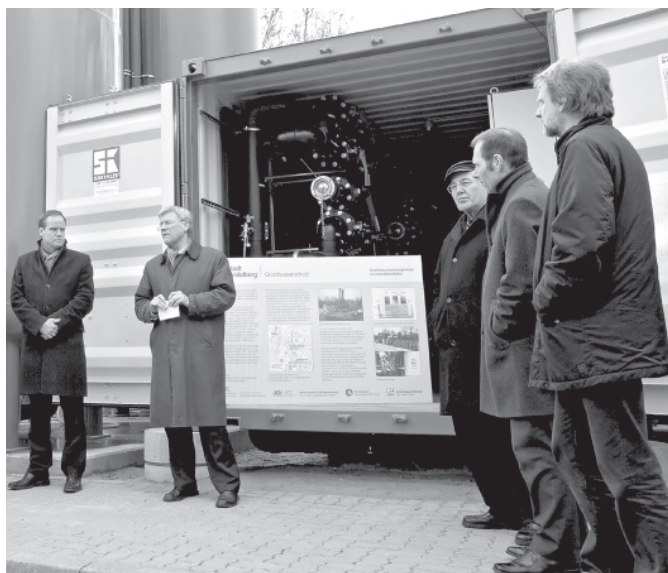
OB Dr. Eckart Würzner und Sebastian Schnitzler vom Regierungspräsidium (v.l.) vor dem Kernstück der Sanierungsanlage Foto: Rothe
