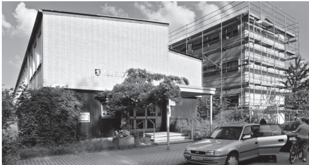
An der Albert-Schweitzer-Schule werden Dach und Fassade saniert, dafür sind 2,88 Mio. Euro im Doppelhaushalt eingestellt. Insgesamt wird in die Sanierung der Schulen 18 Mio. Euro investiert. Foto: Rothe
