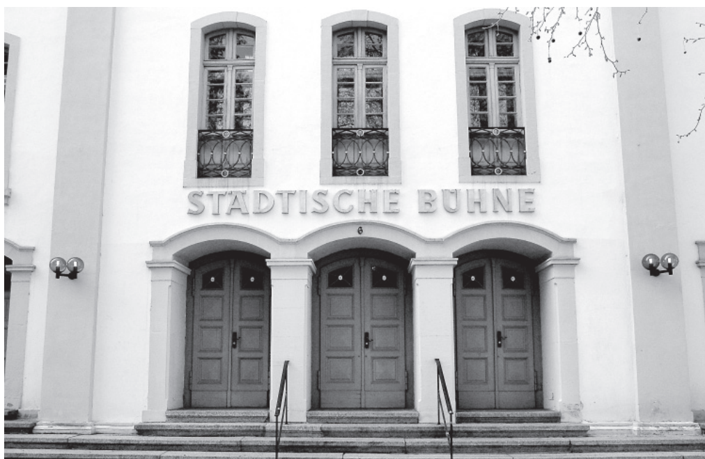
Sanierungsbedürftig: Welche Modelle es für die Sanierung des Heidelberger Theaters gibt, will die Stadt Heidelberg bei einer Informationsveranstaltung am 15. April allen interessierten Bürgerinnen und Bürgern präsentieren. Foto: Dorn
