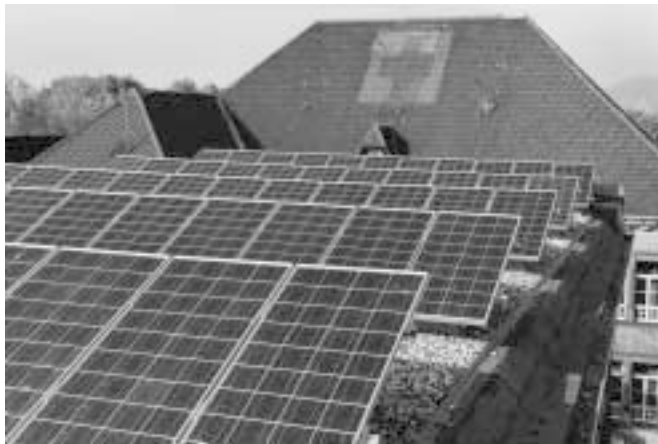
Die Photovoltaik-Anlage auf der Volkshochschule war die erste Gemeinschaftsanlage in Heidelberg. Foto: Rothe
