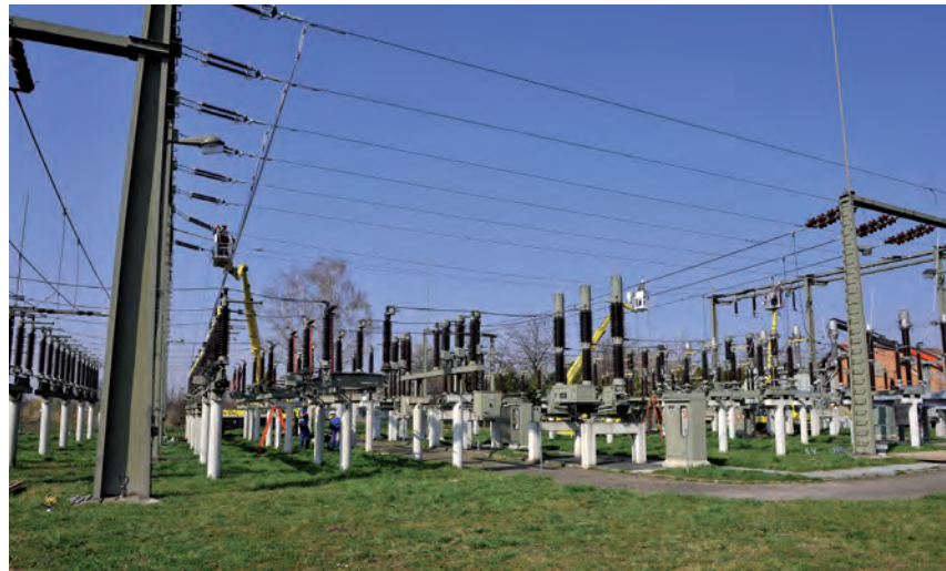
Eine wichtige Aufgabe der Stadtwerke Heidelberg: die Sicherung des Stromnetzes. Bild: Umspannwerk.
