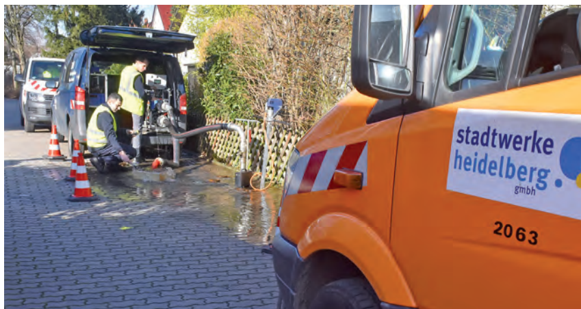
Die Spülung von Hydranten dient der Qualitätssicherung des Trinkwassers.
