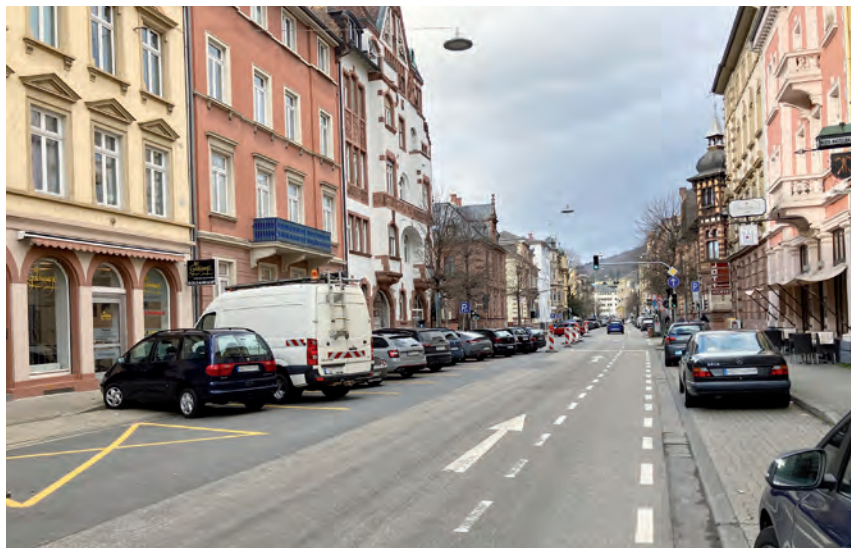
Bald fließt der Verkehr wieder: Die Erneuerung der Fernwärmeleitung in der Rohrbacher Straße steht kurz vor der Fertigstellung – drei Monate früher als geplant.
