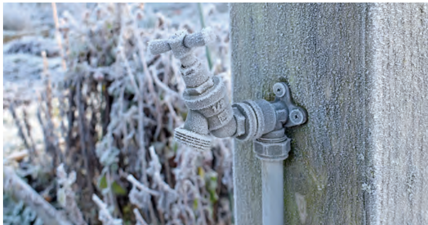
Bevor die Wasserleitung platzt – rechtzeitig vorsorgen und vor Frost schützen.
