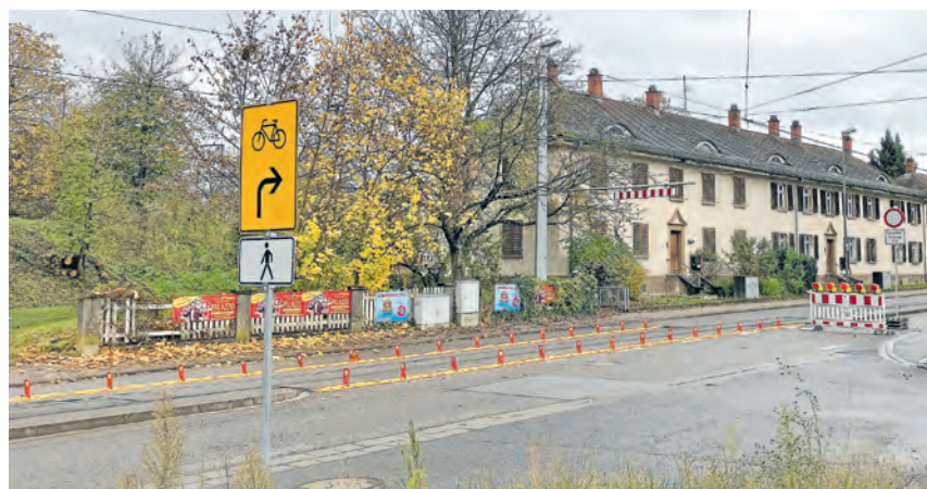
Der Kirchheimer Weg ist Richtung Kirchheim gesperrt. Grund dafür sind Kanalarbeiten im benachbarten Margot-Becke-Ring. (Foto Stadt Heidelberg)
