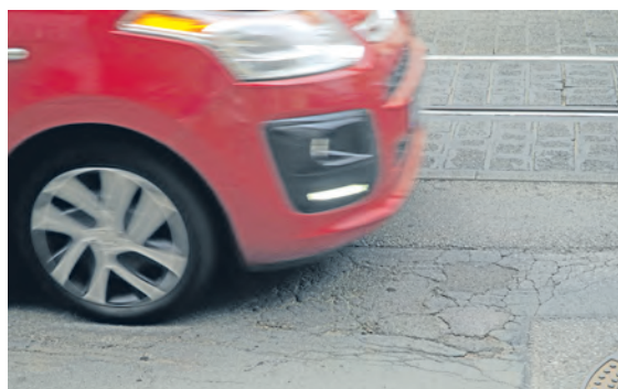
Die Dossenheimer Landstraße muss dringend saniert werden. Im Herbst soll es losgehen. (Foto Stadt HD)
