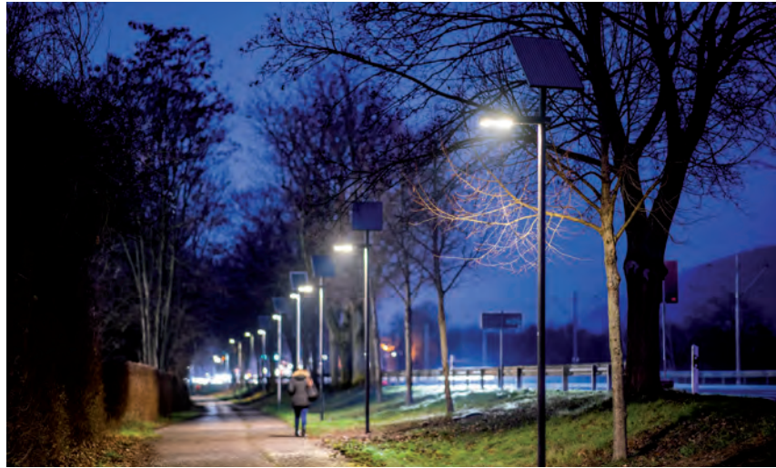
Neue Teststrecke mit Solarbeleuchtung am Radweg in Rohrbach-Süd.
