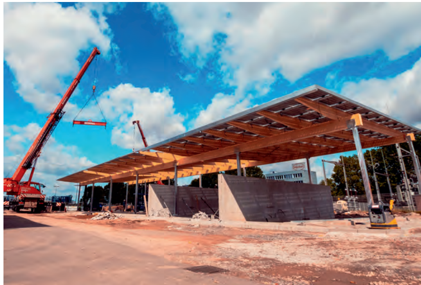
Die innovative Solar-Konstruktion auf dem Werksgelände der Stadtwerke Heidelberg im Pfaffengrund erzeugt wieder mehr Solarenergie für die Region.
