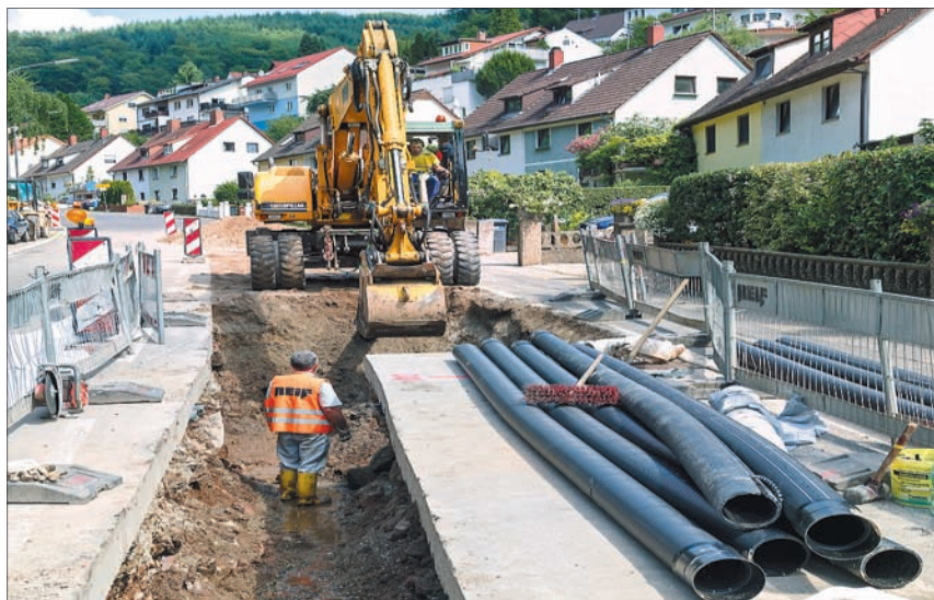
In Ziegelhausen wird nach Ende der Kanalarbeiten die Peterstaler Straße abschnittsweise grundlegend erneuert.
