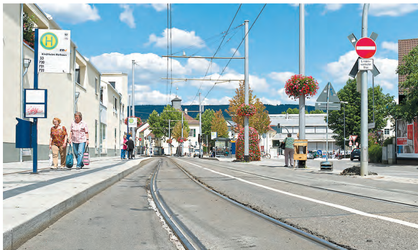
Busse und Taxis ersetzen zurzeit die Linie 26, da sich, wie auf dem Foto zu sehen ist, entlang der Schienen die Vergussmasse gelöst hat.
