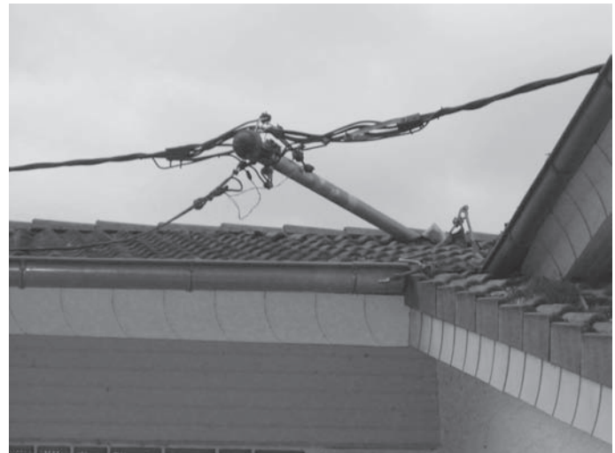
Verankerung durch den Sturm gelöst
