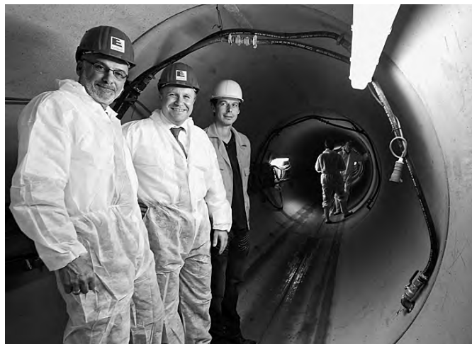
Besuch in zwölf Metern Tiefe: Erster Bürgermeister Bernd Stadel (M.), Jürgen Weber (l.), stellvertretender Leiter des Tiefbauamtes, und Uwe Ludwig vom Abwasserzweckverband Heidelberg erlebten den Kanalvortrieb „live“ mit: Während ihres Besuchs wurde die Röhre um einige Zentimeter nach vorn gepresst. Foto: Rothe
