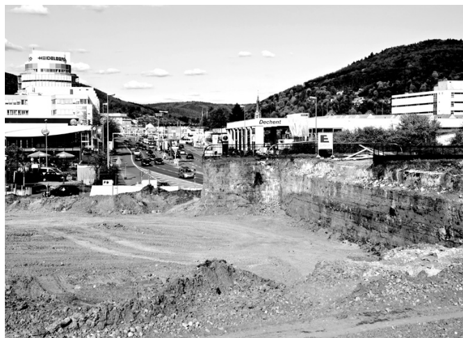
Der Engpass in der Speyerer Straße fällt weg: Die Bahnbrücke (rechts) wird abgebrochen und die Straße vierspurig ausgebaut. Foto: Rothe
