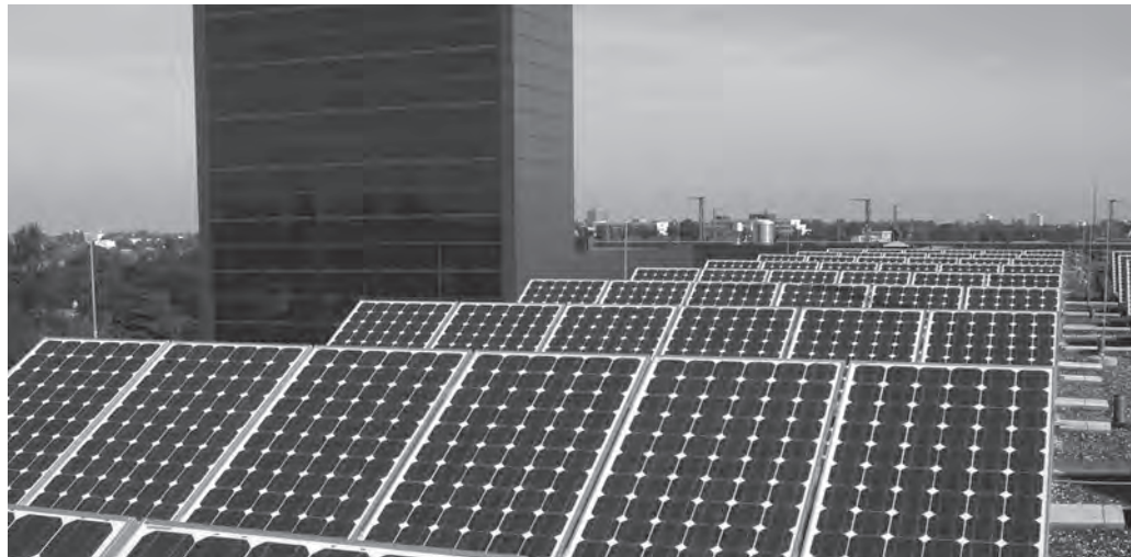
Photovoltaik-Anlage: Neue Berufsfeuerwache
