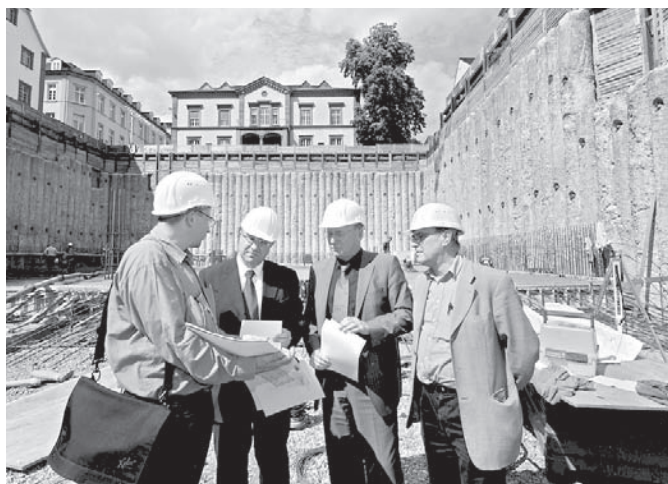
Vor Ort im derzeit „größten Loch Heidelberg“ (v. l.): Architekt Uwe Bellm, Erster Bürgermeister Bernd Stadel, HGG-Geschäftsführer Michael Jäger und Statiker Josef Steiner. Foto: Rothe
