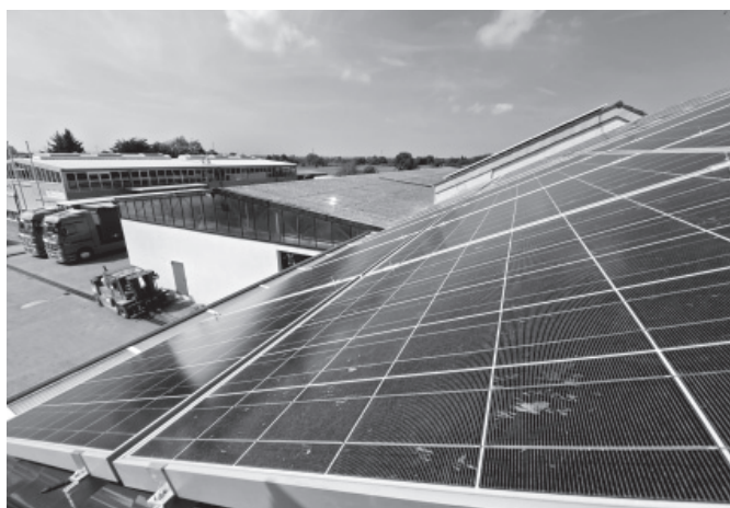
Die Firma Fels erzeugt Solarstrom auf Dachflächen, die sie zur Einsparung von Heizenergie dämmen ließ. Foto: Rothe
