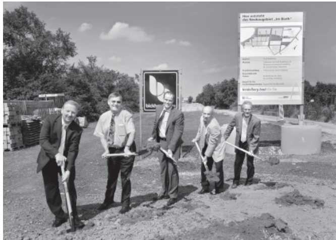
Beim Spatenstich für das Kirchheimer Neubaugebiet „Im Bieth“: (v. l.) Kai-Uwe Sax von der Baufirma Sax und Klee, Dieter Berberich, Vorsitzender des Stadtteilvereins Kirchheim, Oberbürgermeister Dr. Eckart Würzner, Tiefbauamtsleiter Ulrich Zwissler und Heinz Knoll, Technischer Vorstand der Stadtwerke Heidelberg. Foto: Rothe
